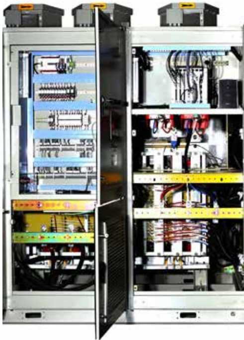
Obudowa sekcji sterowania i transformatora
