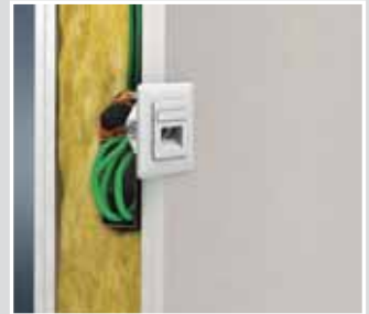
Miejsce na nadmiar kabla.
