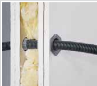
Przepust w ogniowej ścianie g/k.
