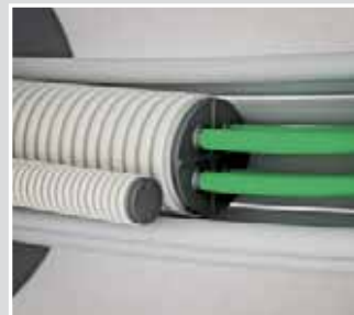
Puste rury elektroinstalacyjne mogą posłużyć za rezerwę.
