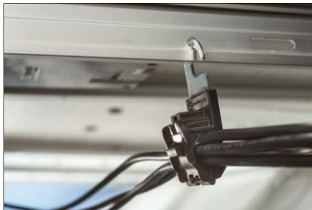
Obejma Ratchet P-Clamp zamocowana do panelu fotowoltaicznego.
