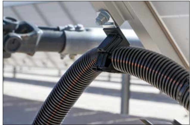
Zarządzanie przewodami na trackerach w instalacji fotowoltaicznej.
